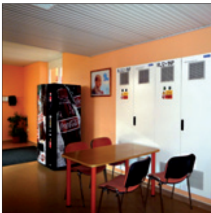
Volný přístup musí být také ke všem rozvaděčům, hlavním uzávěrům, hasičím přístrojům, hydrantům...
